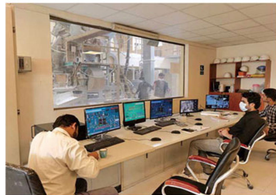
中央控制系统 Central control system
